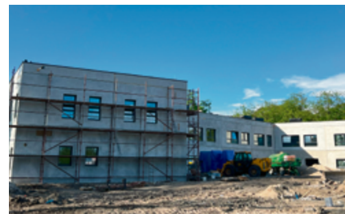
Budowa przedszkola w Rawiczu - trwają prace polegające na wstawianiu okien, układaniu ogrzewania podłogowego i zalaniu posadzek.
