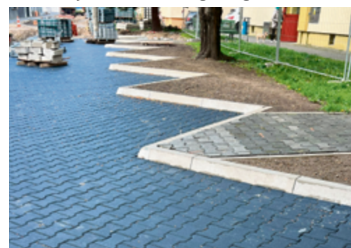
Przebudowa ul. Piotra Skargi w Rawiczu - trwa układanie chodnika z kostki betonowej.
